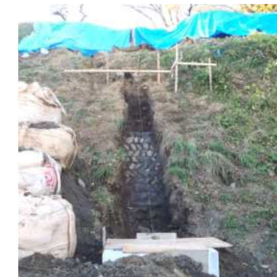
図 7 法面の盛土内部から見つかった古い擁壁（コンクリ使用）
