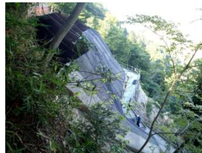
図6 本丸東側崖面の災害復旧工事 グラントアンカー打ち込み 上部：連続繊維補強土工 下部：吹付砕工+防護柵工
