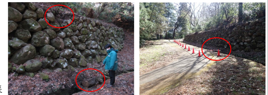
落石状況(左) 応急措置完了後(右)
