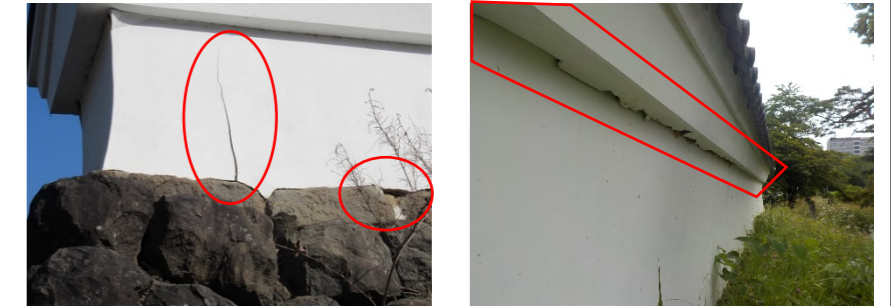
亀裂・剥離状況
