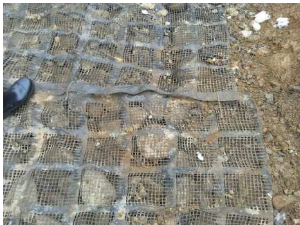
ジオテキスタイルは健全(破断なし)
