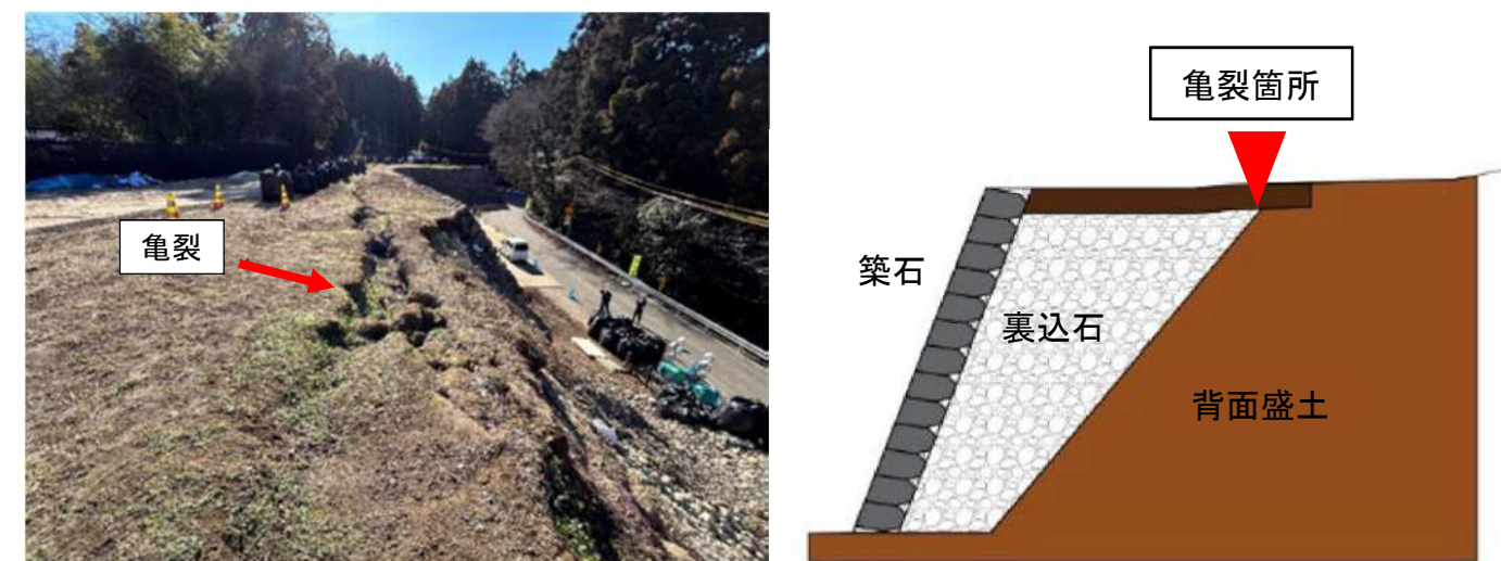
図 2.2 E面亀裂写真と亀裂箇所
