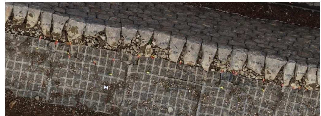
図5.3.1 中段ジオテキスタイルの破断状況(上空写真)
