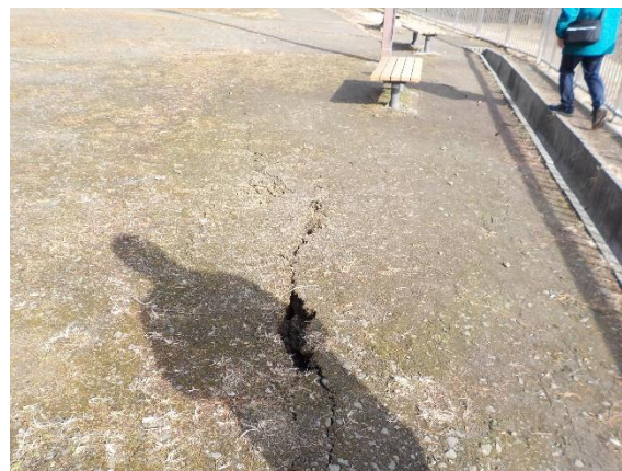
地割れ状況(南から)
