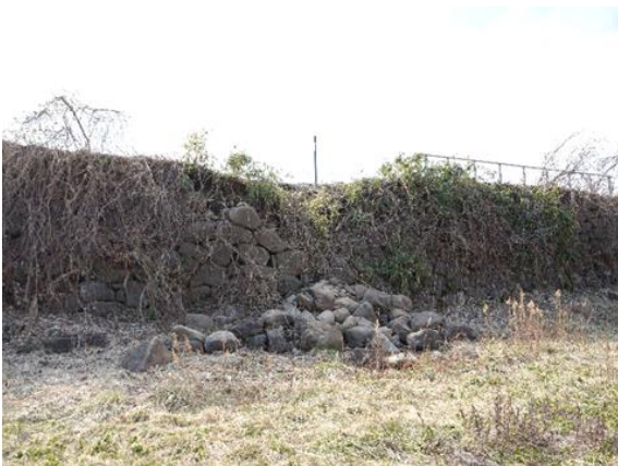
崩落状況(南東から)
