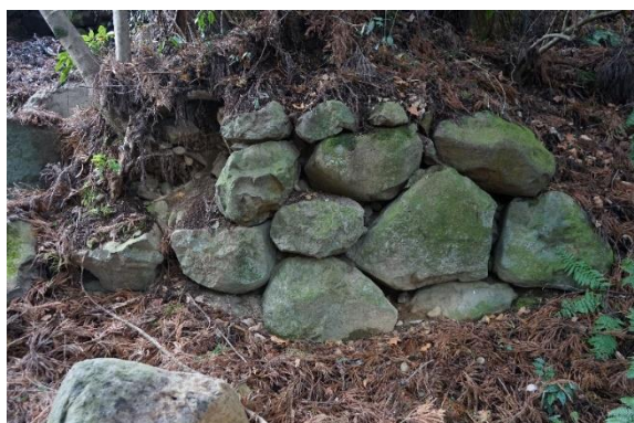
E面崩落状況(北から)
