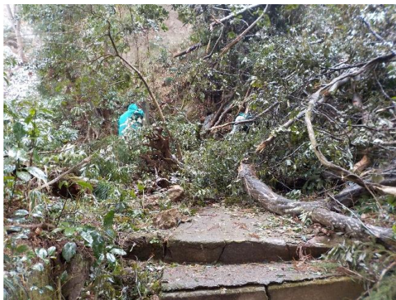
崩落箇所 A 蛸崎神社周辺状況(東から)
