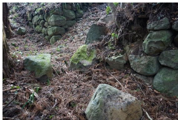
E面崩落状況(北西から)
