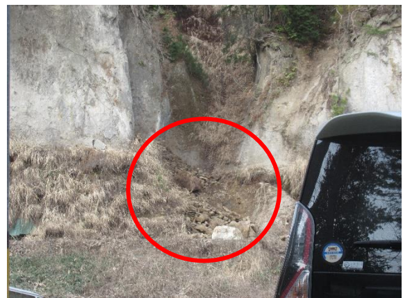
崩落箇所 C 状況 (北東から)
