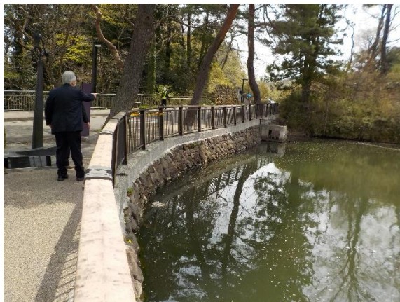
護岸変形状況(北西から)
