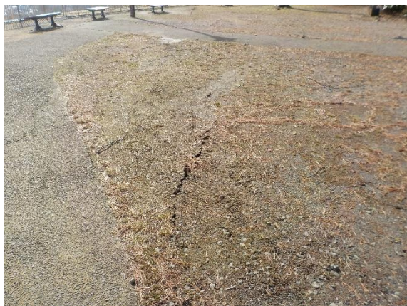
地割れ状況(北西から)
