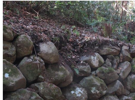
天端石落下箇所（北東から）
