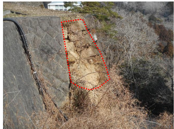
F 面端部補強石材・盛土崩落状況 (南から)
