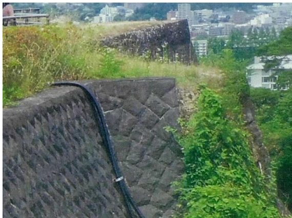
F 面端部被災前の状況【2020 撮影】(南から)
