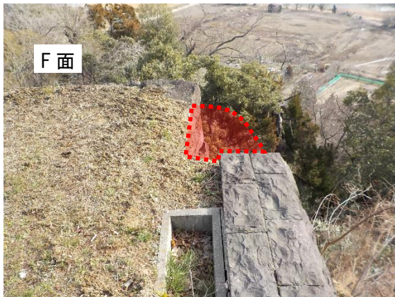
F 面端部補強石材・盛土崩落状況 (南西から)
