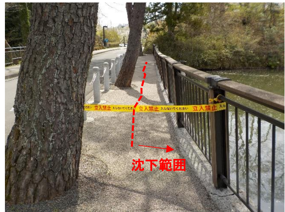
園路沈下状況(北から)
