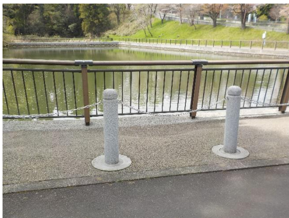
園路沈下状況(東から)
