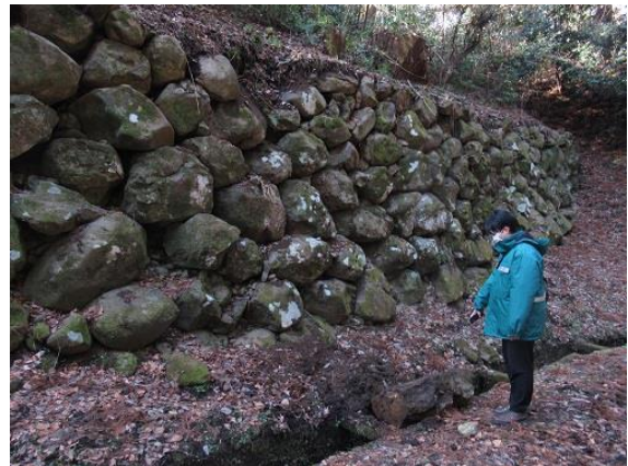
天端石落石状況（北東から）
