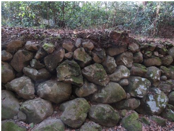
石垣変形状況（北から）
