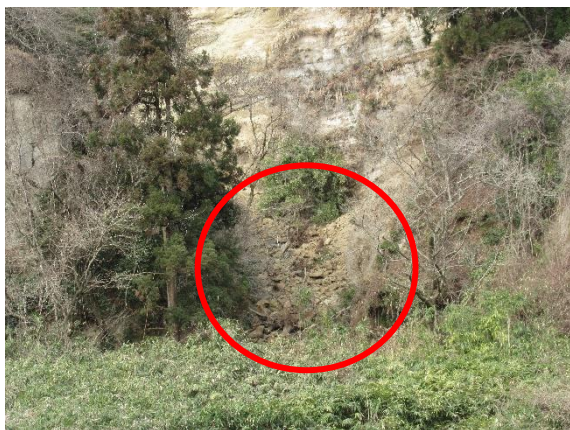
崩落箇所 B 状況 (北東から)
