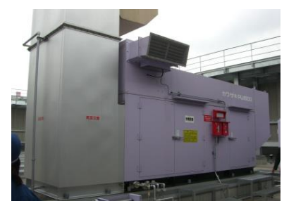
非常用発電機
