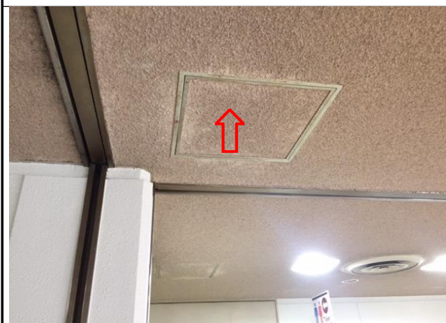
シャッター定期点検による天井点検口廻り摩耗飛散痕
