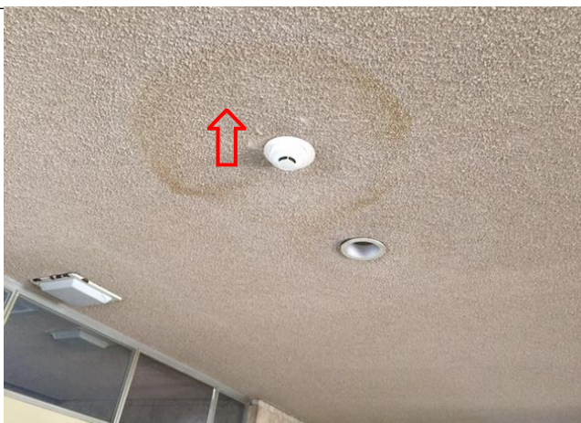
配管漏水と思われるがアスベストが有り処置できない
