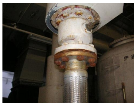
本庁舎機械室 揚水ポンプの状況
